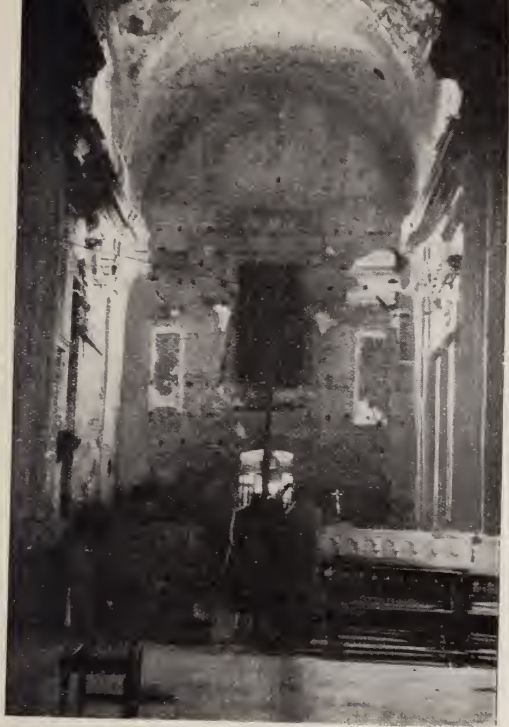
Santo Domingo. — Vista general del interior, después del incendio.
